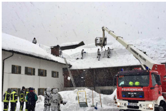
Mit vereinten Kräften räumen Einsatzteams der Gebirgsjägerbrigade 23 und der Feuerwehr Schnee von Hausdächern in den heimischen Landkreisen.
